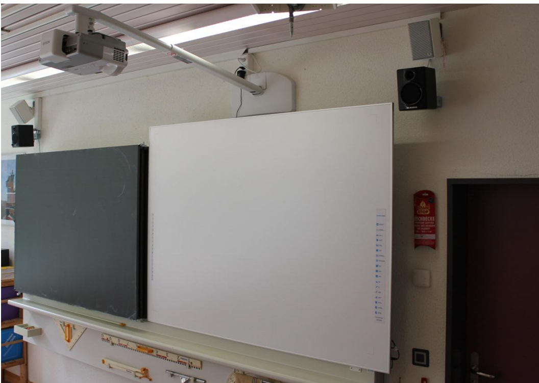
Sekundar-Schulzimmer in Winterthur: neue Kurzdistanzbeamer unterstützen den multimedialen Unterricht.
